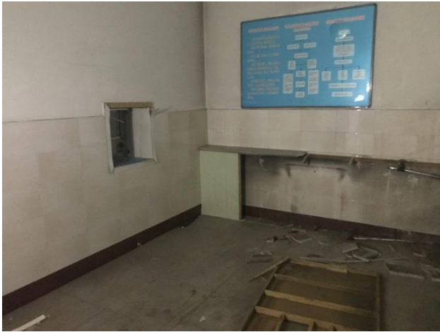
核医学科一层注射室
