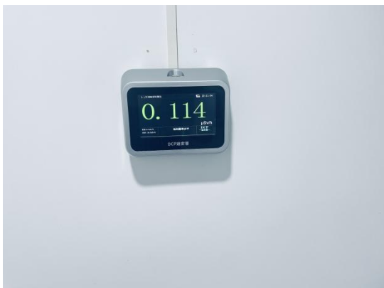
核医学科负一层区域辐射检测仪
