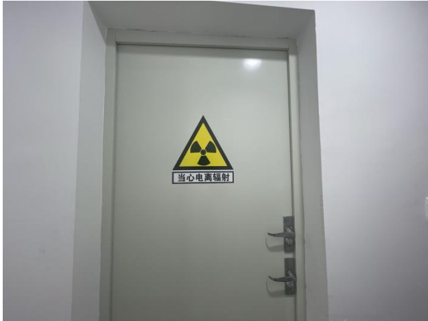
负二层源室防护门
