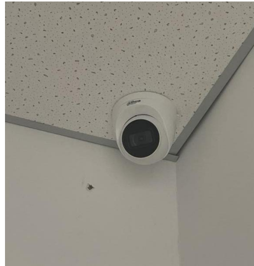
负二层源室视频监控
